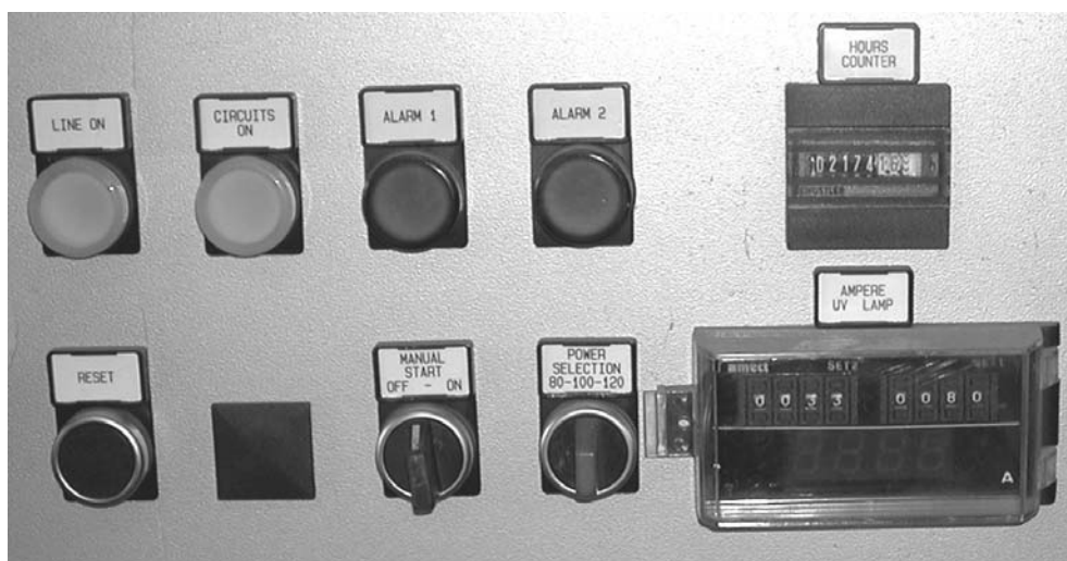
Figuur 3.6: Schakelpaneel van een éénlamp 100% UV-tunnel. De vermogensschakelaar van de UV-lamp (POWER) SELECTION kent de standen 80, 100 en 120 W/cm. Er is voorzien in een Ampèremeter (AMPERE UV-LAMP), hetgeen een indicatie geeft van het lampvermogen. Tevens is een brandurenteller (HOURS COUNTER) ingebouwd.
