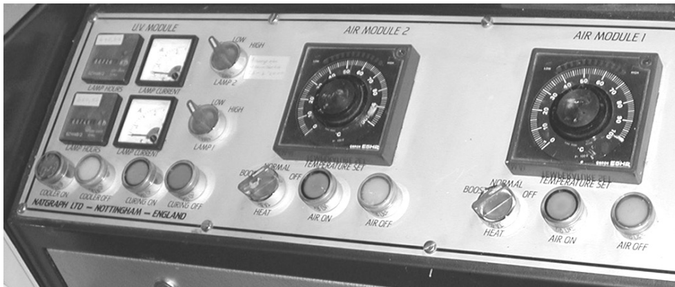
Figuur 2.1: Schakelpaneel van een combi-tunnel, bestaande uit 2 warmelucht-secties en 2 UV-stralers. Het vermogen van de stralers wordt aangegeven op de 2 (witte) Ampèremeters. Rechts daarnaast de instelknoppen voor het lampvermogen, die de standen LOW of HIGH kennen. De grote zwarte temperatuurregelaars behoren bij de twee warmelucht secties.
